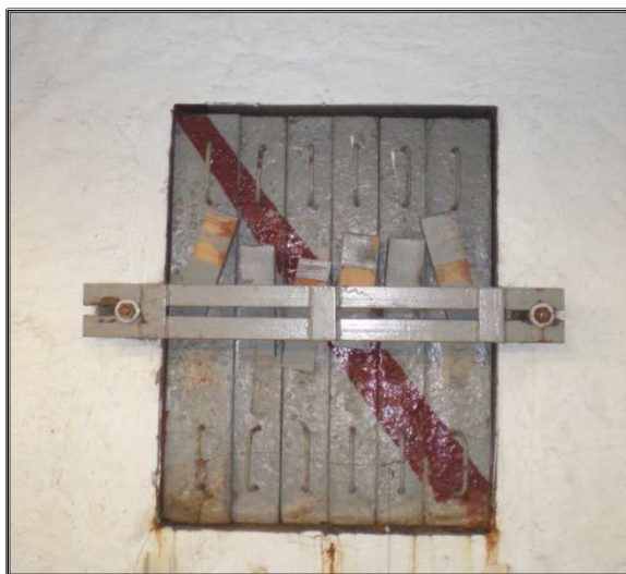
Dörren till en igenbommad nödutgång i Arkivdepå 2. Det var troligen här som vattnet kom in i lokalen. Foto: J Andersson
